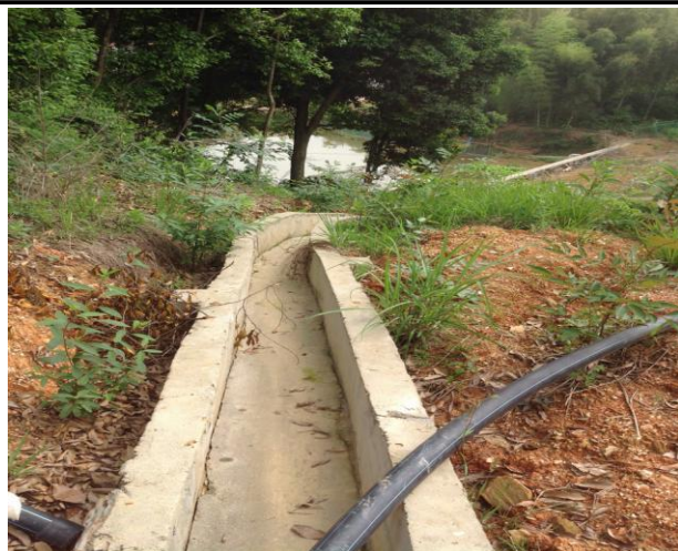
场区西北面雨水导流沟
