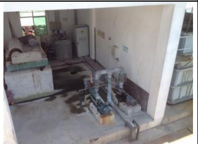
污水处理站机泵
