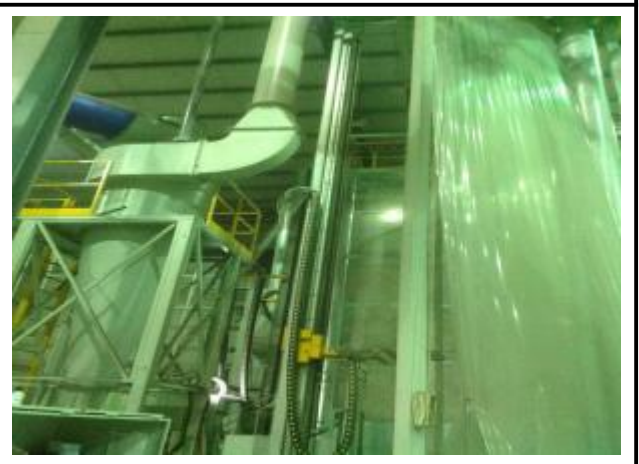
喷涂废气处理（旋风除尘器）
