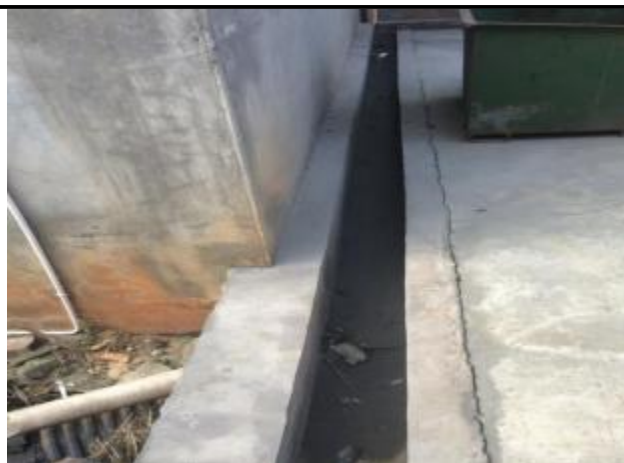
厂区雨水管网
