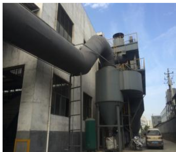
废气处理设施集气管道
