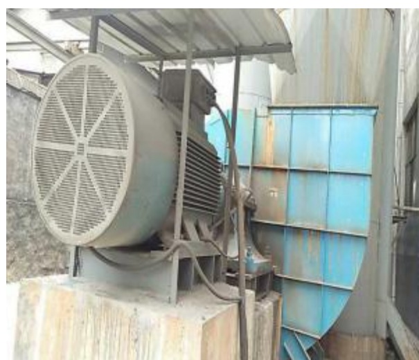
废气处理设施机泵
