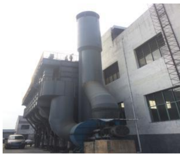
废气处理设施
